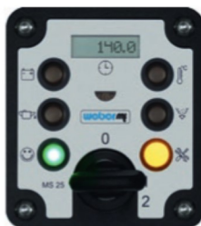
Ukazatel při dosažení a překročení termínu údržby.
